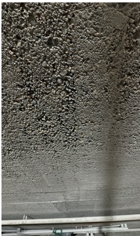
Betondecke mit Sanierungsbedarf.
