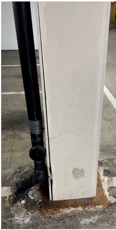
Stahlträger vor der Sanierung.
