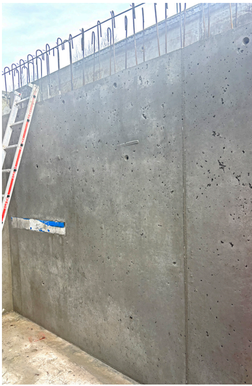
Wände im UG mit RC-M 40 und SikaFiber® Force-50.
