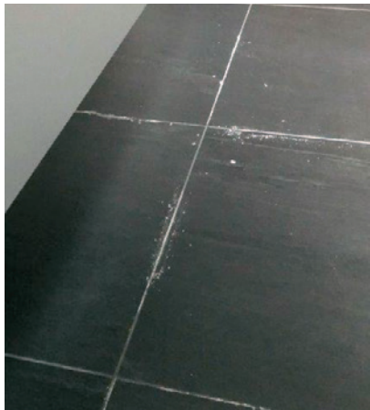
Ausblühungen und Salzkristallisation auf angrenzenden Bodenbelägen
