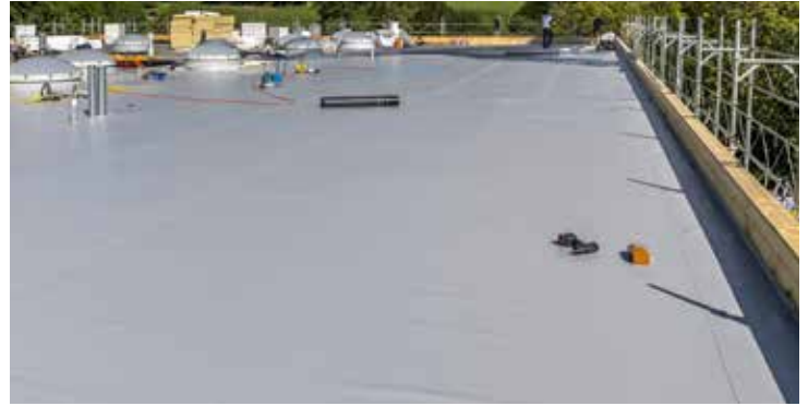
Ein grosser Vorteil der Sika-Abdichtung ist, dass die Rollen schnell verlegt und die Bahnen in kurzer Zeit miteinander thermisch verschweisst werden können.
