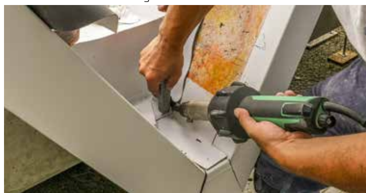
Durch die thermische Verschweissung konnten die vielen Anschlüsse einfach und sicher ausgeführt werden. Ausserdem gab es weder Rauch- noch Lärmmissionen während der Arbeit.
