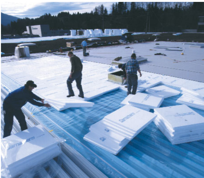
Übersicht eingebauter Sektoren
