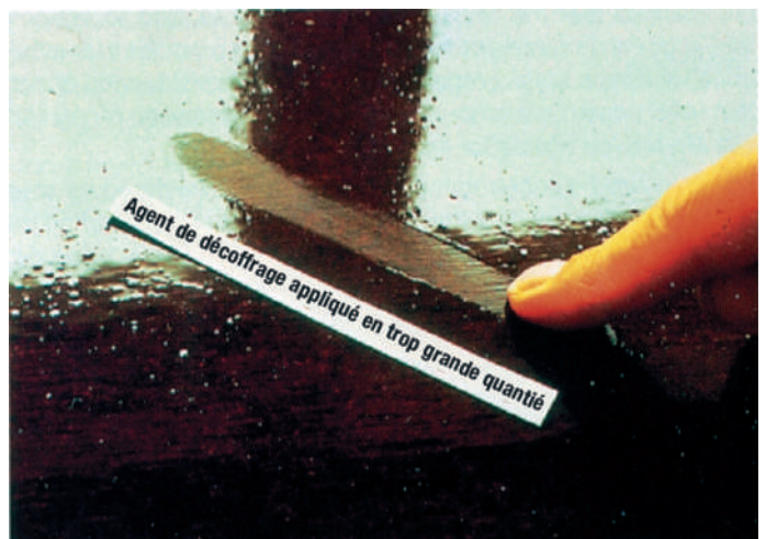
Agent de décoffrage appliqué en trop grande quantité.
