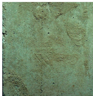
Farinage de la surface du béton p.ex. dû à un problème de prise (sucre).
