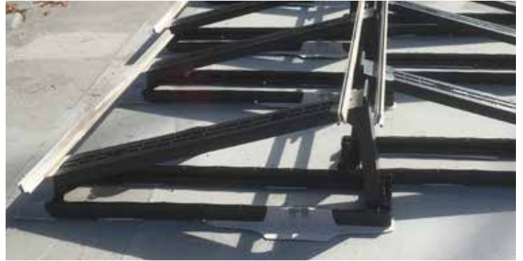
Sika SolarMount-1, das einfach zusammengebaute Befestigungssystem konnte danach mit den Solarpanelen bestückt werden.
