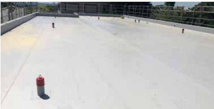
Das fertige Nacktdach mit SikaRoof AT: eine solide, widerstandsfähige Basis für die Fotovoltaik-Anlage.
