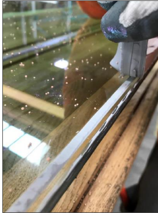
Figure 31 : adhérence défailante, échec du test de dévitrification
