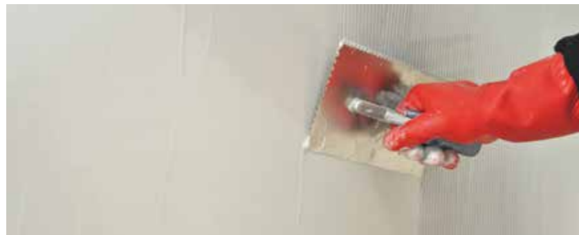
Auch die 2. Schicht SCHÖNOX® EA PUR S mit einer Kelle abglätten und die Schichtdicke prüfen.
