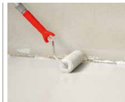
Innerhalb von 12 - 24 Std. die 2. Lage SCHÖNOX® EA PUR mit einer Rolle auftragen.
