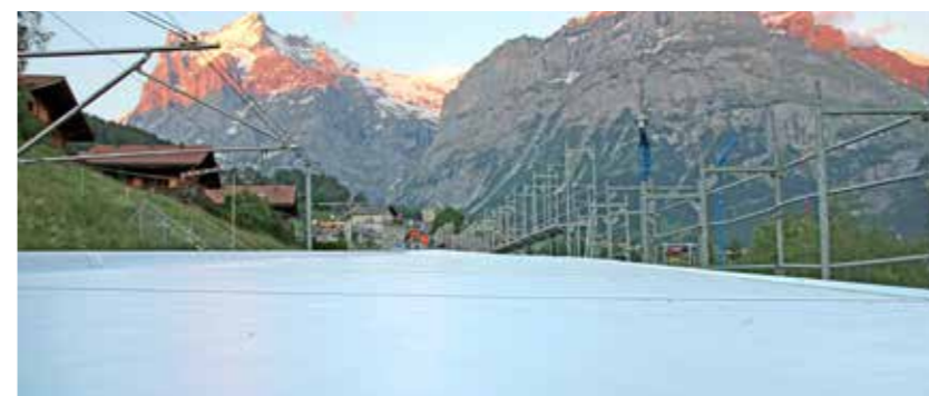
La toiture des quais a été équipée en premier d'une toiture nue TPO de Sika.
