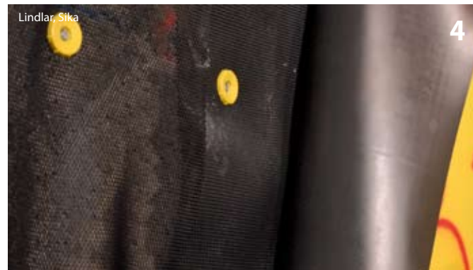
Die Drainagematte ist an den Abdichtungsträger mit Rondellen (PVC) befestigt (links). Die Abdichtungsbahn (bergseitig schwarz, luftseitig signalgelb) wird danach an den Rondellen angeschweißt
