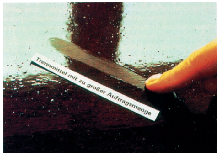
Zu hoher Trennmittelauftrag.
