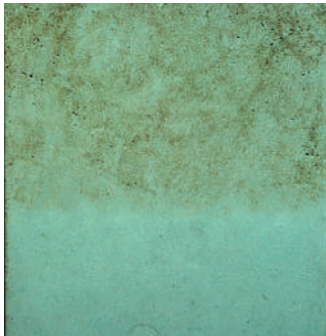
Verfärbungen durch pfützenartigen Auftrag des Trennmittels.
