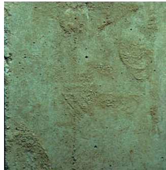
Abmehlen der Betonoberfläche, z.B. durch Abbindestörung.
