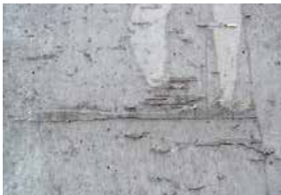
Abb. 21: Folgen einer defekten Schalung
