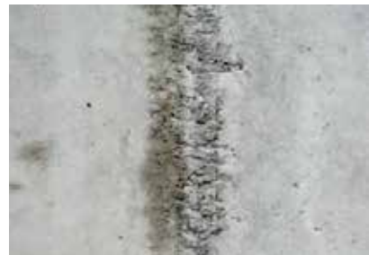
Abb. 22: Farbunterschiede an einer nicht abgedichteten Arbeitsfuge
