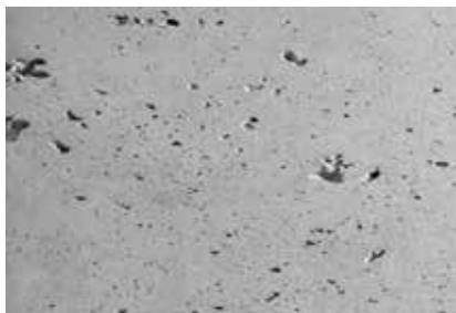
Abb. 23: Starke Poren- und Lunkernbildung infolge mangelnder Verdichtung
