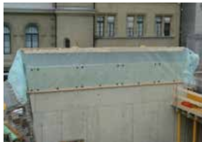
Abb. 20: Schutz vor Rostfahnen
