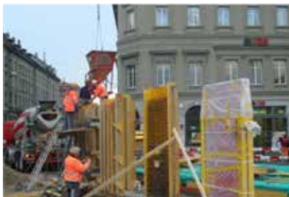
Abb. 19: Kantenschutz und Schutz vor Verschmutzung
