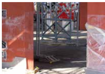
Abb. 26: Ausblühungen infolge Kondenswasserbildung
