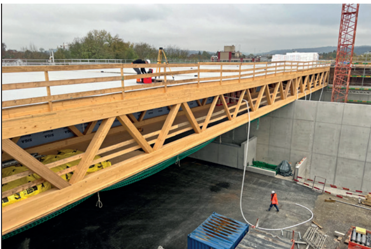
Die Holzkonstruktion musste zum Schutz vor der Witterung möglichst schnell abgedichtet werden.
