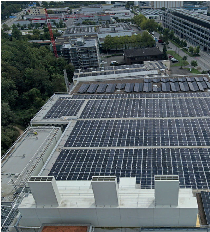
Für das Dach des Gewerboneubaus kam das flammenfrei verarbeitbare System Sarnafil® TG 76 18 FSA zum Einsatz.
