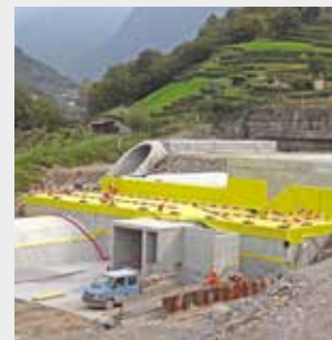
CENTRALI DI AERAZIONE
