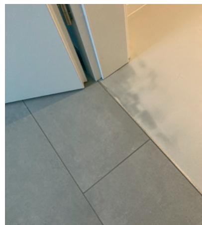
Dommages dus à l'humidité sur les revêtements adjacents en dehors de la zone humide
