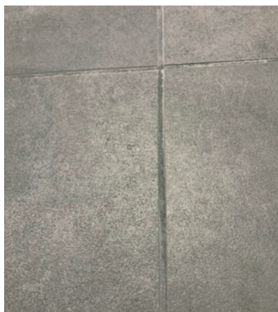
Décolorations ou assombrissement des joints
