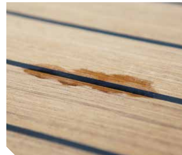
Beschädigtes Teakdeck durch Wassereintrich
