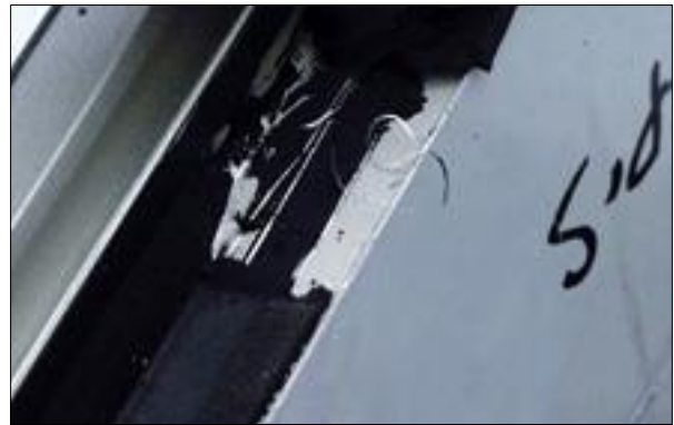
Figura 32 – Esempio con giunto SG nero difettoso; adesione compromessa
