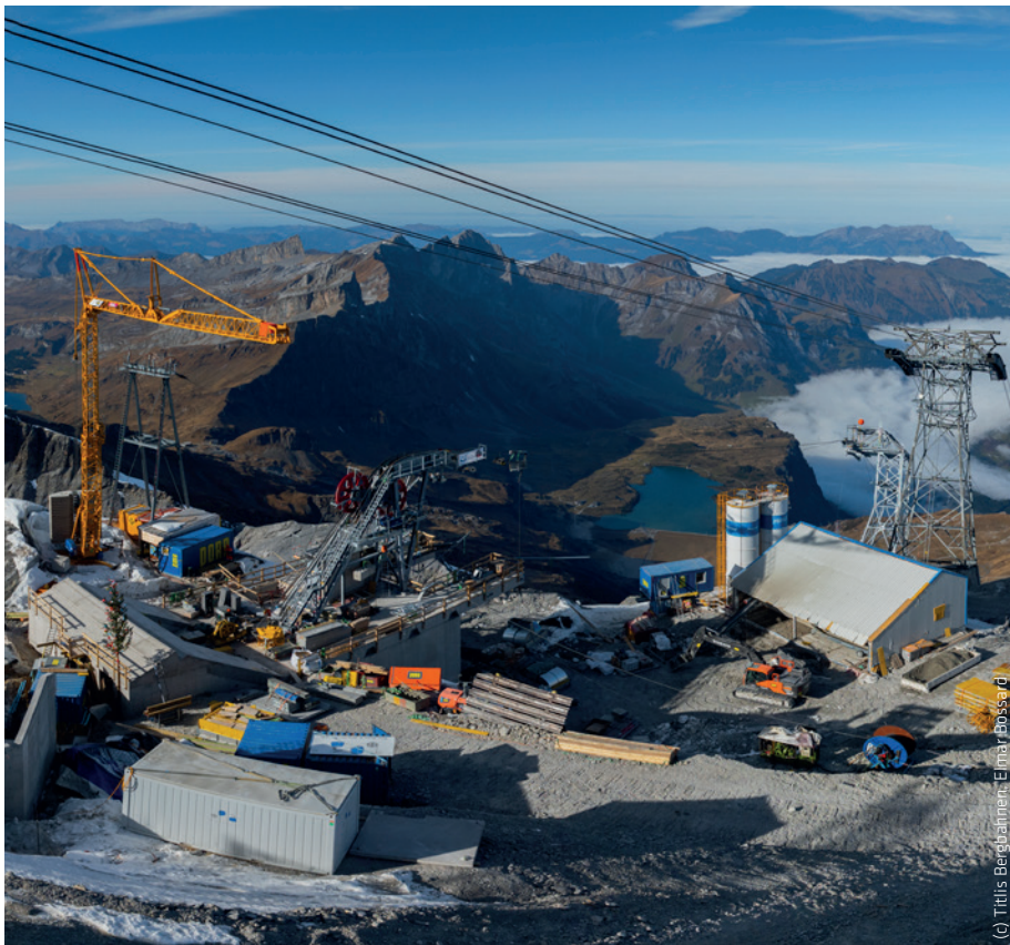
Die Titlis-Baustelle mit neuer Ortsbetonanlage – mit faszinierender Aussicht auf die Bergwelt und den Trübsee.
