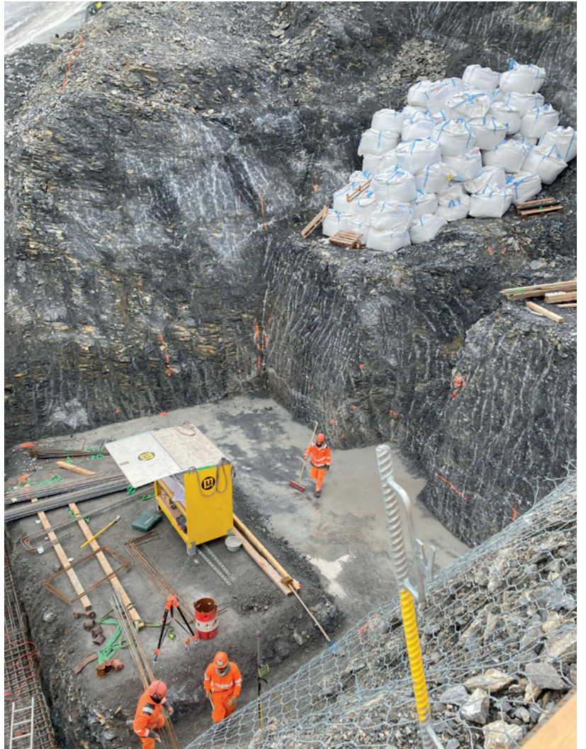
Baugrube in alpiner Höhenlage. Für die Erstellung des Betonfundaments der Seilbahnmasten wird mit einem Primärkies-depot in Big Bags gearbeitet.
