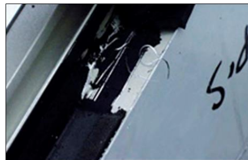
Figure 40 : exemple avec joint SG noir - adhérence défectueuse
