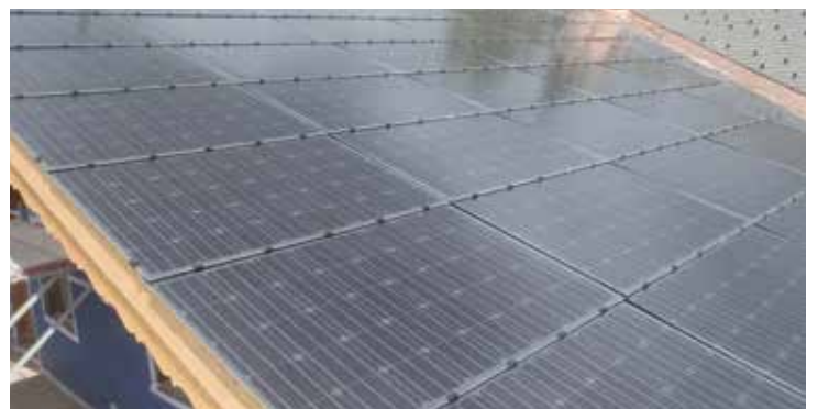
Das Sika Dachsystem bildet eine sichere Grundlage für die Photovoltaikmodule von SolarUp.
