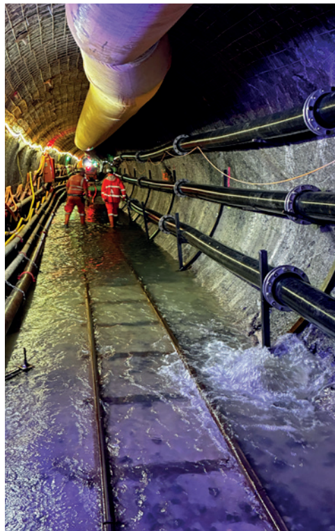
Wassereintritt im Tunnel.
