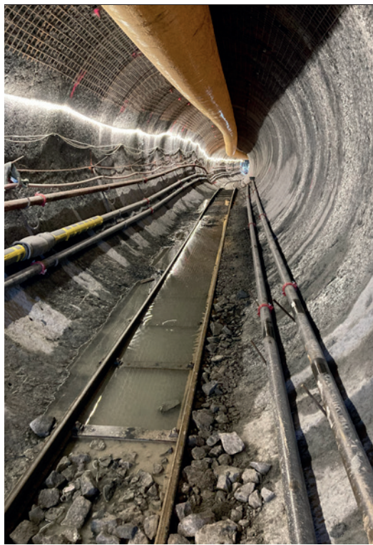
Entlastungsstollen mit integrierter Entwässerungslösung.
