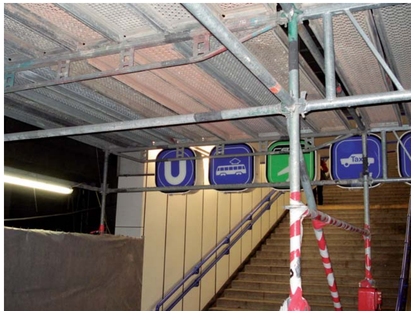
Bild 2. Treppe zur U4 mit Arbeitsbühne und tiefer gehängten Infrastrukturelementen (Quelle: Jahn).
