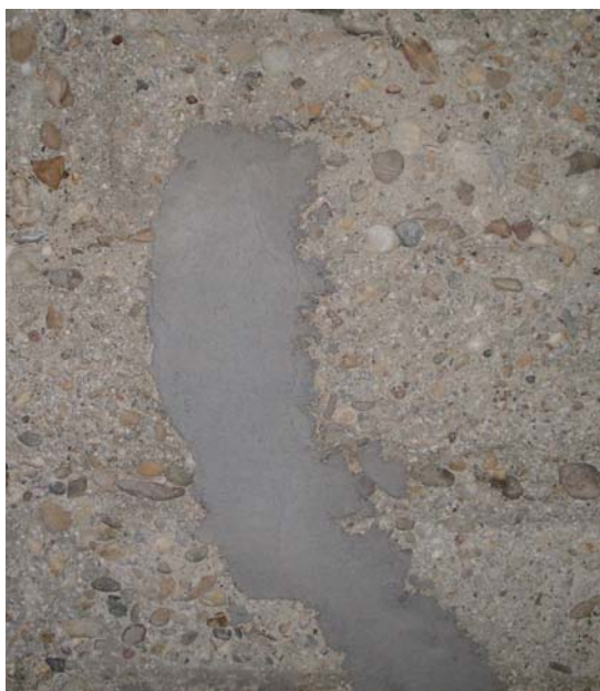
Bild 7. Korrodiertes Stahl wurde mit Korrosionsschutz behandelt und mit Reprofilierungsmörtel ausgeglichen (Quelle: Jahn).
