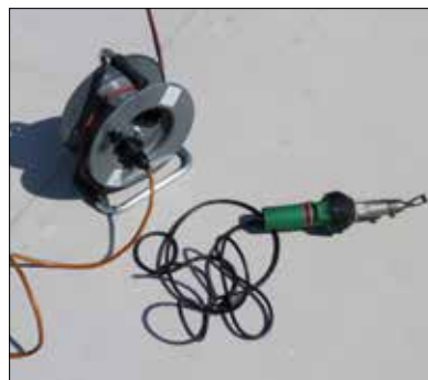
Fig. 6 : Thermosoudure d'une nouvelle membrane sur la membrane existante ( Sarnafil® TS 77-18 ) sur le toit du bâtiment Meusburger de Wolfurt (Autriche)
