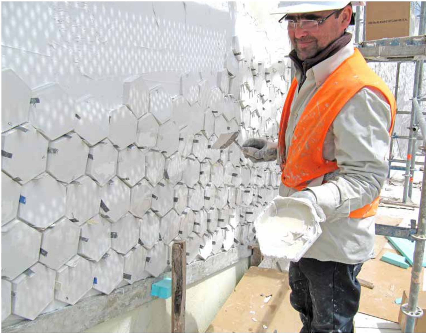
Étant donné les conditions de travail très compliquées sur les surfaces verticales, les applicateurs ne pouvaient coller que 5 m 2 de carrelage par jour et par personne.
