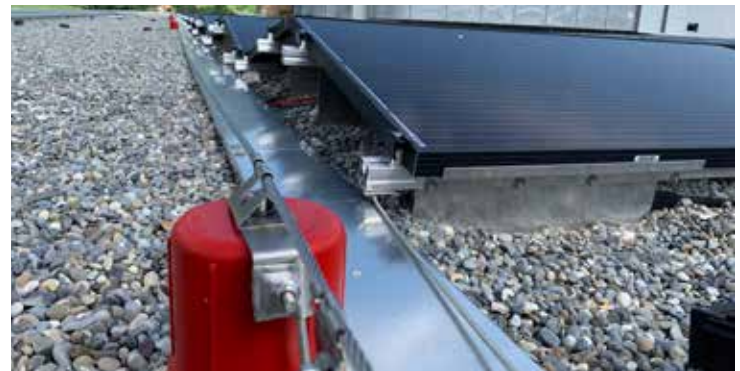
Mittels Seilsicherung Seculine Vario aus dem Hause Sika kann ein sicherer Dachunterhalt gewährleistet werden
