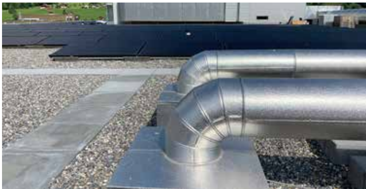
Das Dach musste vielen Anforderungen wie z.B. Lüftungsrohren und Photovoltaikanlage standhalten.
