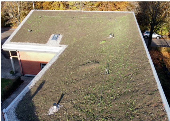
Die Kombination Abdichtung, Schubabsicherung und Begrünung auf einem geneigten Gründach funktioniert.
