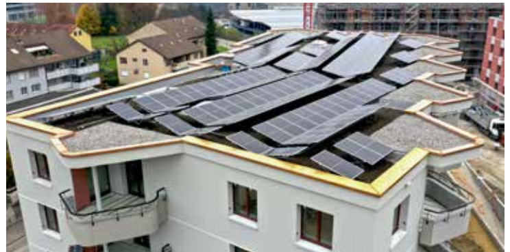
Das Sikadach bietet die solide Basis für die Solarpaneele und unterstützt den ökologischen Gedanken der Überbauung.
