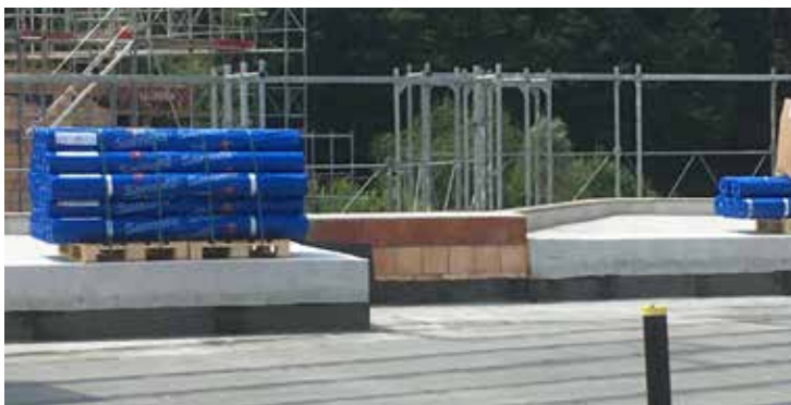
Die praktischen Rollen der Sika®-Abdichtung machen ein Dach innert kurzer Zeit dicht. Auch sind nur wenige Kranzüge nötig, um das Material aufs Dach zu bringen.
