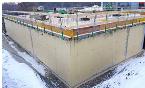
Système SikaProof® A+ pour application sur un coffrage double face. Les trous des écarteurs doivent encore être étanchés ultérieurement.
