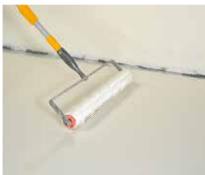
Passer l'étanchéité au rouleau à pointes (longueur des pointes env. 1 cm) et contrôler l'épaisseur de couche.
