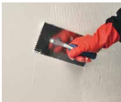
Die aufgebrachte Schönox® EA PUR S-Zahnung mit einer Kelle abglätten und die Schichtdicke prüfen.
