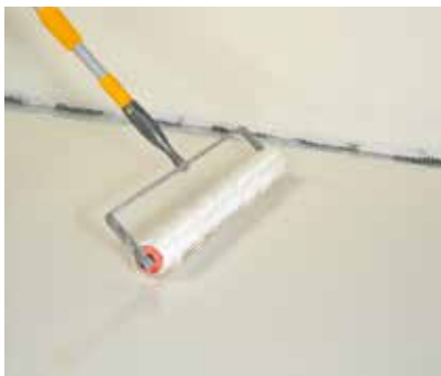
Die Abdichtung mit einer Stachelwalze (Stachellänge ca. 1 cm) abrollen und die Schichtstärke prüfen.
