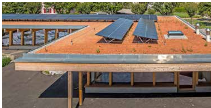
Das Hybrid-TPO-Dach ist höchst widerstandsfähig und bildet die solide Basis für die Fotovoltaik-Anlage.
