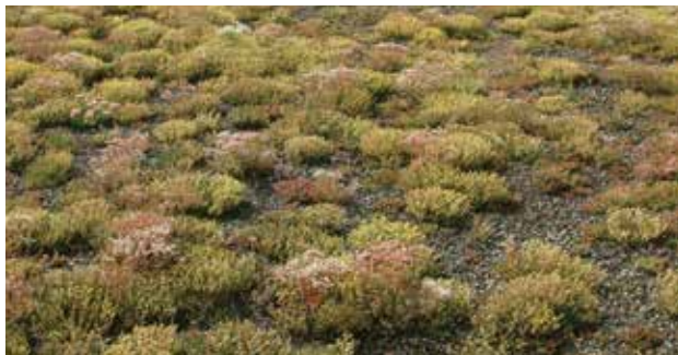
Ansaat mit Sedumarten | Ensemencement avec des variétés de sedum
