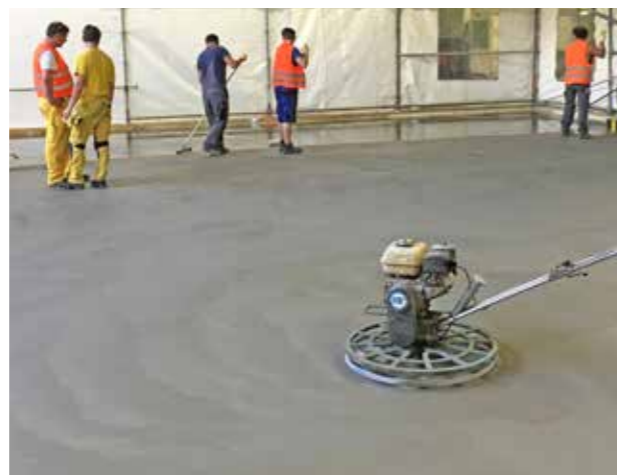
Application de la couche de fond possible 1.5 heure après la fin du lissage (+20°C)
