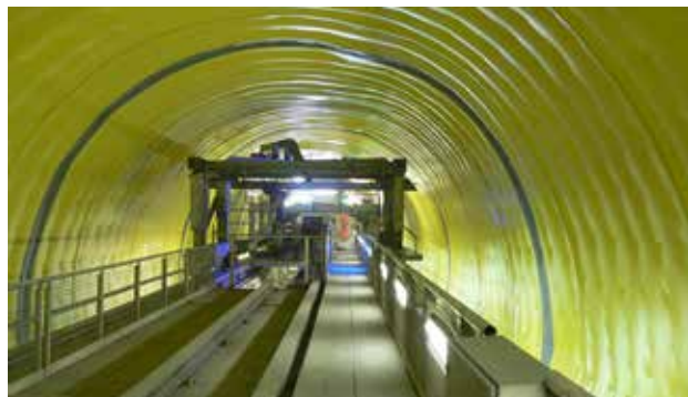
Sistemi durevoli d'impermeabilizzazione applicati dopo il consolidamento con calcestruzzo spruzzato e prima della realizzazione degli anelli interni in calcestruzzo.
