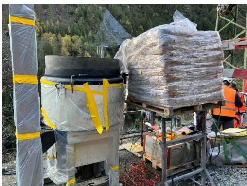
Fig. 11: piattaforma accanto al miscelatore.
