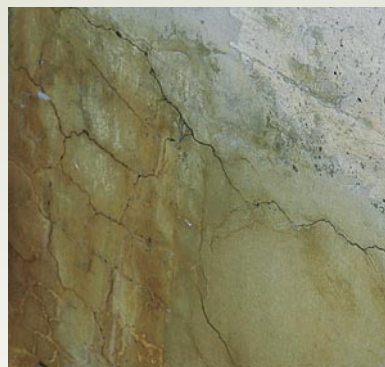
Fissures dans la paroi latérale du bassin
