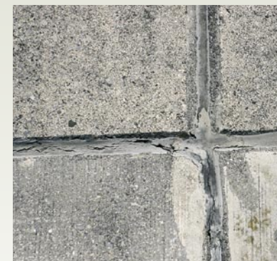
Matière de colmatage de joint non étanche
