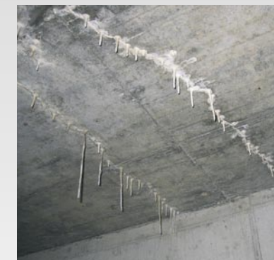
Infiltrations sur la face inférieure du plafond
