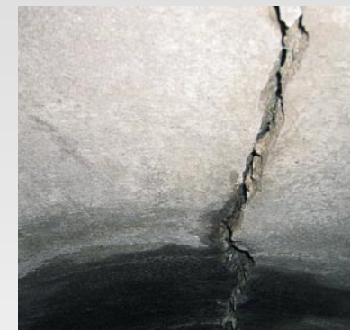
Fissure avec infiltration d'eau: danger pour la pureté des eaux souterraines
