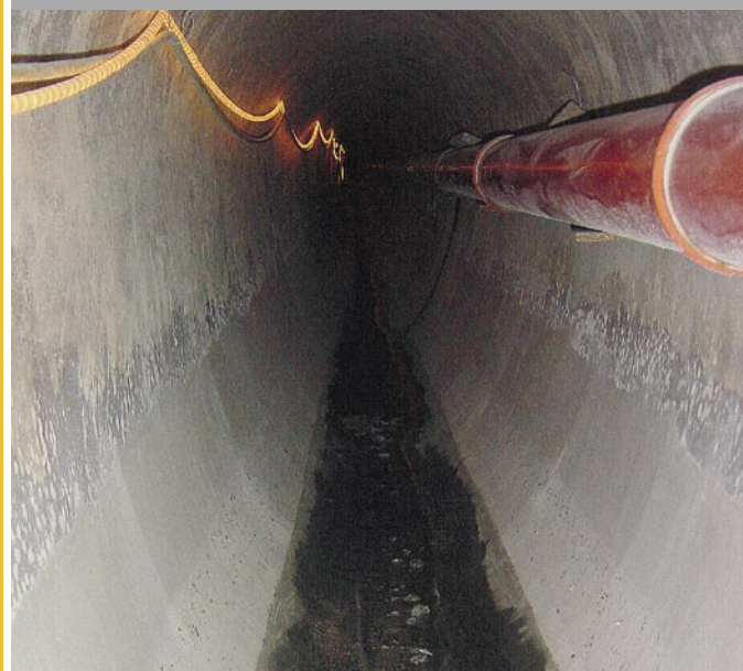
Zone de sollicitation B: Le béton endommagé se trouve souvent dans cette zone
