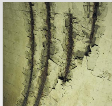
Dégâts importants du béton sur les parois latérales
