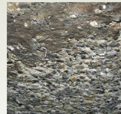
Dégâts important dans le digesteur
