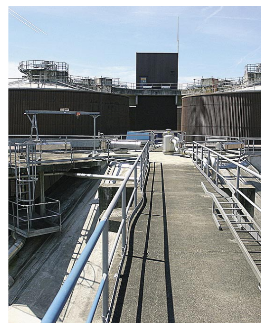
Digesteurs: Attaque chimique par de l'acide sulfureux
