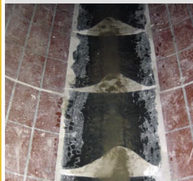
Forte érosion et abrasion au fond de l'égout
