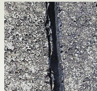
Joint de dilatation endommagé sur la face intérieure du bassin
